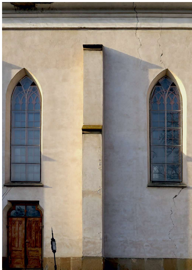
Prasklá zeď na jižní straně kostela (foto březen 2025):
